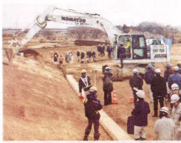
鬼怒川の築堤工事現場で、のり面の形を整える半自動制御の油圧ショベル＝7日、常総市三坂町
